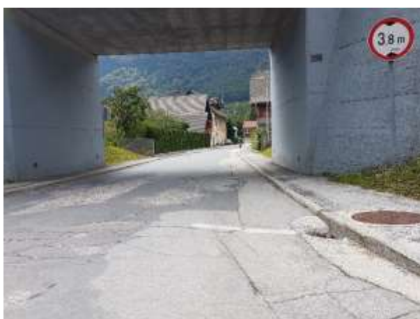
Slika 38: Slabo vzdrževane prometne površine predstavljajo neposredno nevarnost za kolesarje in pešce
