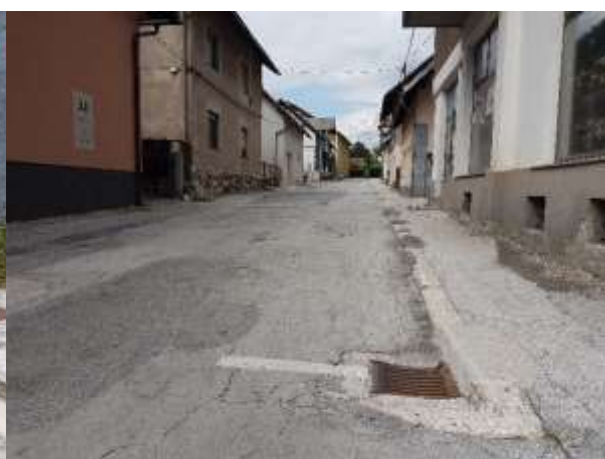
Slika 39: Še en primer slabo vzdrževane in nevarne prometne površine
