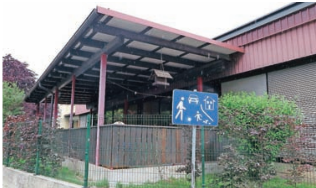
Tako streha kot sama stavba nista izolirani, stavbno pohištvo je dotrajano in v celoti potrebno zamenjave.
