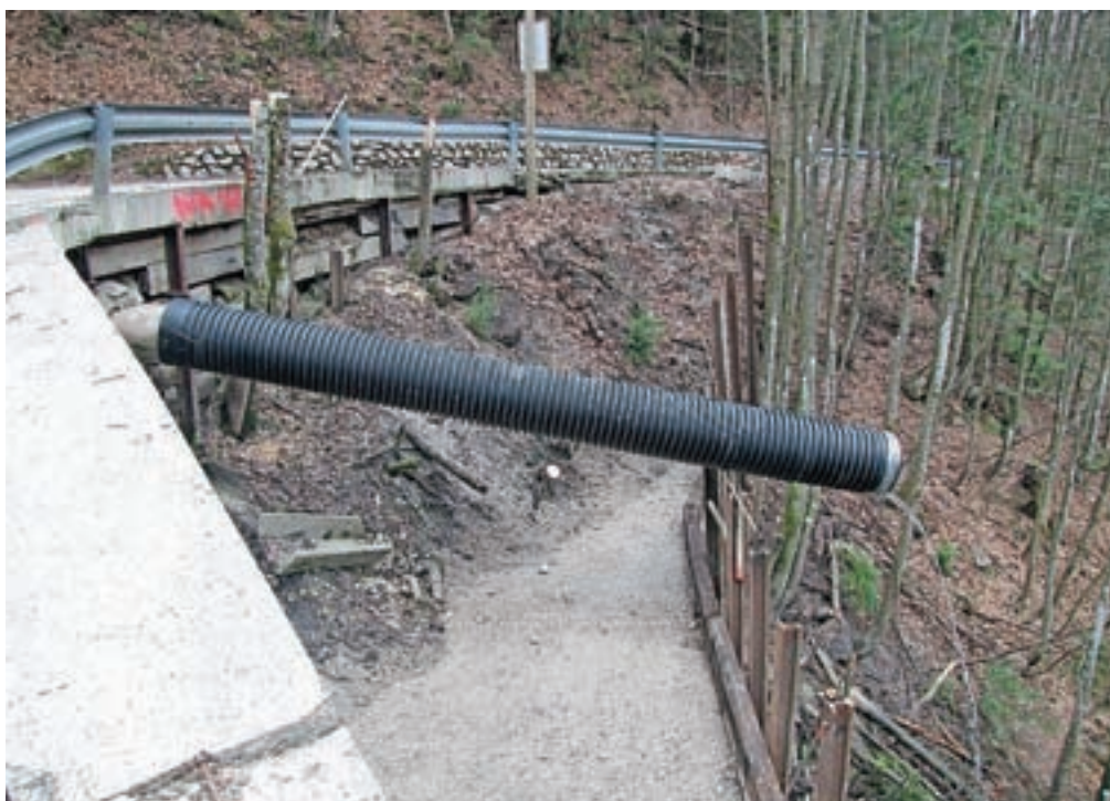
Cesta je bila močno poškodovana zaradi plazov, zato je obnova nujna. / FOTO: OBČINA JESENICE
