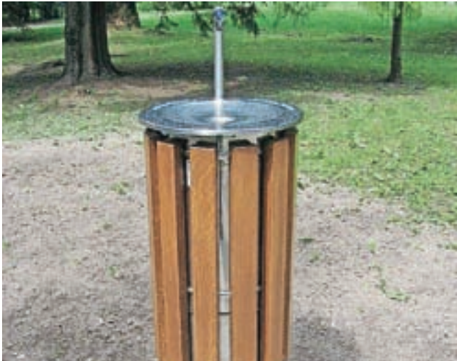
Uničeni ventili na pitniku v Spominskem parku
