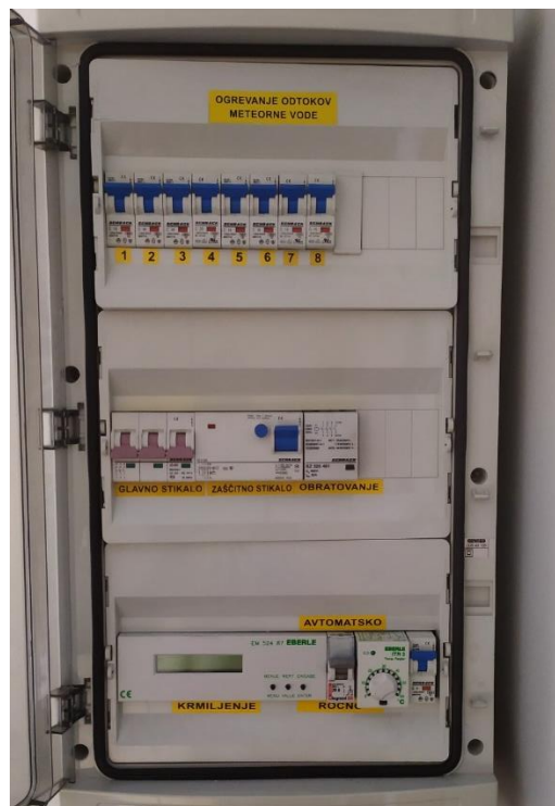
Slika 31: Elektro omara – ogrevanje žlebov
