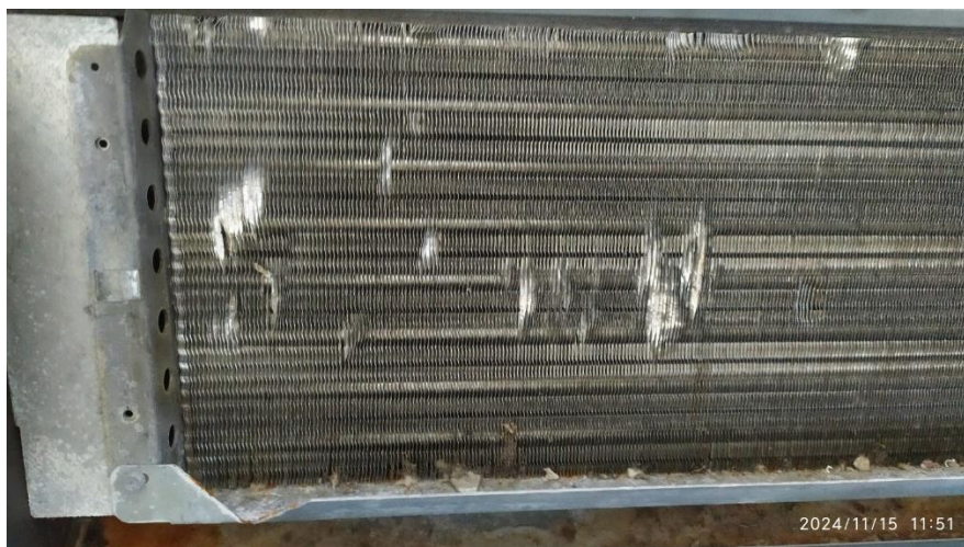
Slika 22: Poškodovana rebra konvektorja
