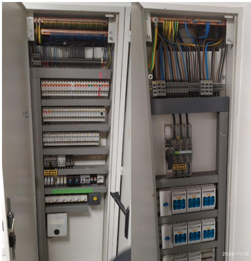
Slika 28: Levo razdelilna elektro omara R-K, desno glavna omara R-G
