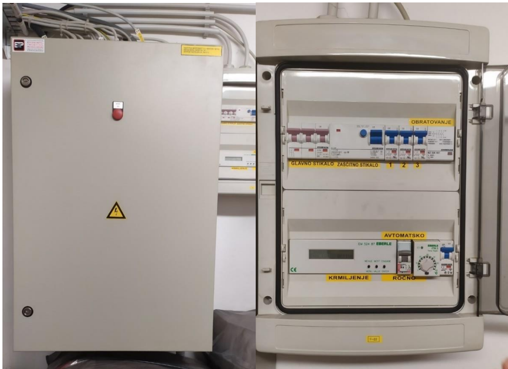
Slika 30: Levo razdelilna elektro omara za garažo, desno za ogrevanje klančine
