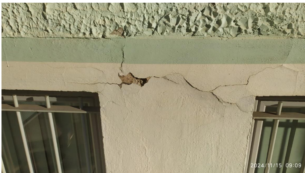
Slika 49: Poškodbe na fasadnem ometu
