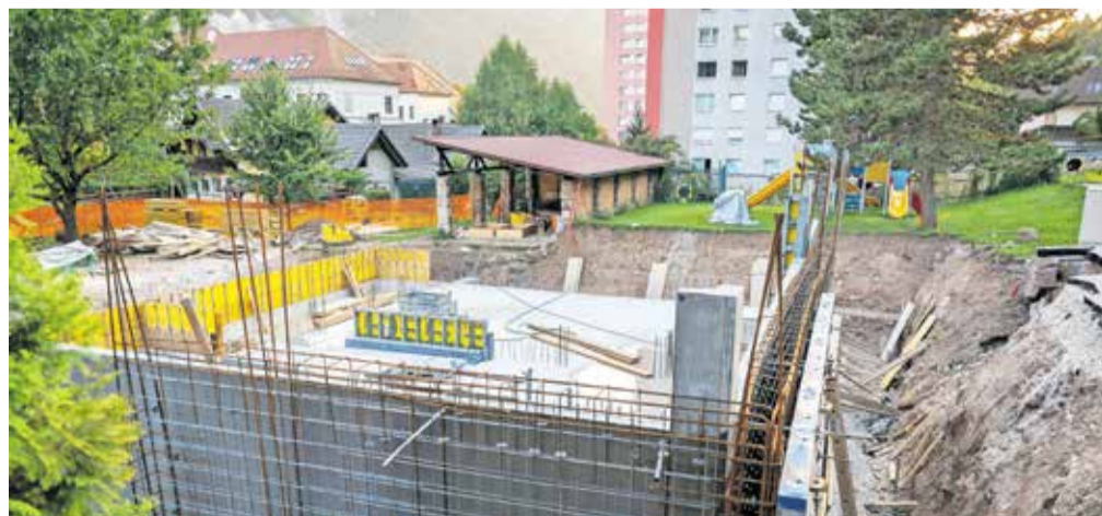
Na Jesenicah gradijo novi vrtec Julke Pibernik, gradnja napreduje po načrtih, zgrajen naj bi bil do marca prihodnje leto. / FOTO: NIK BERTONCELIJ
