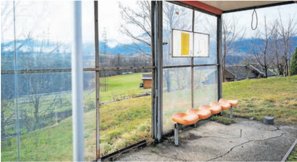
Uničena avtobusna nadstrešnica je celo brez stekla. / FOTO: NIK BERTONCELJ
